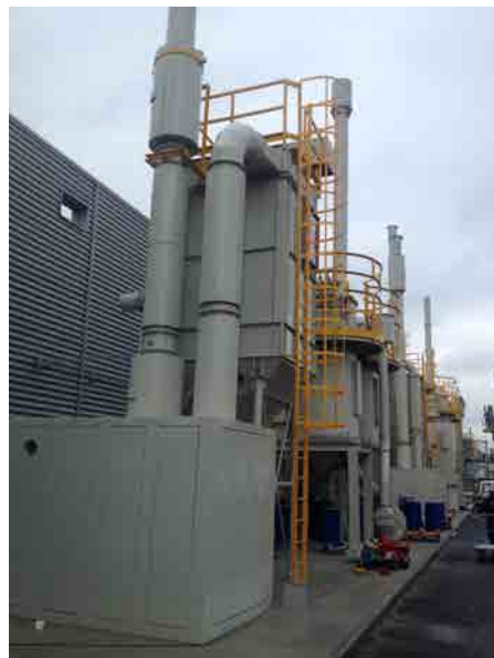
Impianto rimesso a nuovo. Revamped plant
